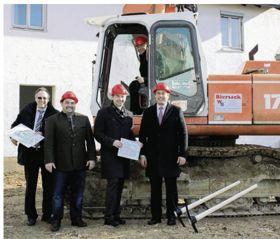
Gaben den Startschuss für die Abbrucharbeiten: Geschäftsleitender Beamter Hans Schmid, Werner Biersack, Josef Wenninger von der Volksbank, Bürgermeister Josef Pellkofer (im Bagger) und Bauträger Dipl.-Ing. Richard Balk.
